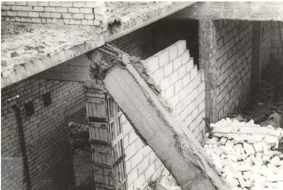
Joonis 2. Raudbetoonist konsooltala purunemine tõmmatud sarrusvarraste vigase jätku tõttu
